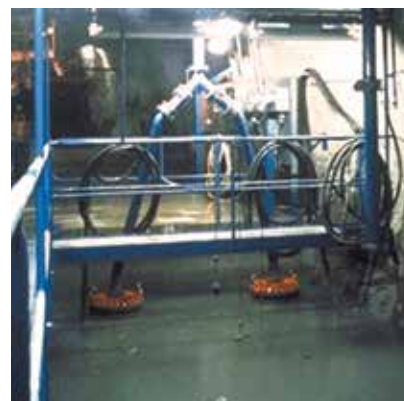
Общий вид насосной станции с погружными дренажными насосами
